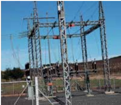
Staal elektrisiteit krag torings
